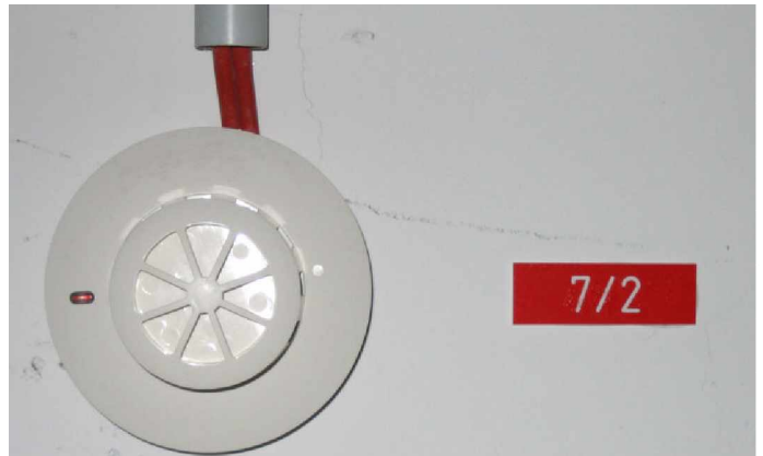
Automatischer Brandmelder mit Anbindung an eine Brandmeldeanlage
