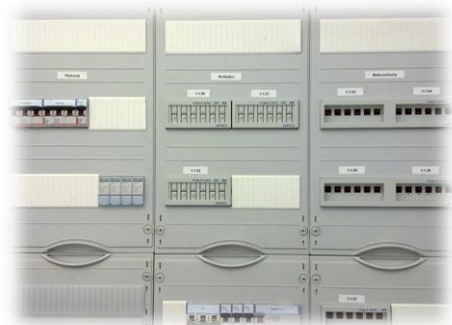
Bildquelle: MPS Elektrotechnik GmbH
