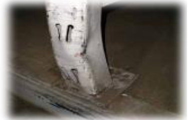
Beschädigte Stütze und gerissene Schweißnaht an der Fußplatte.
