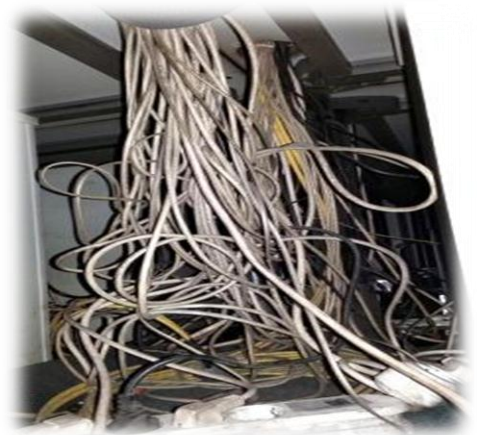
Bildquelle: MPS Elektrotechnik GmbH
