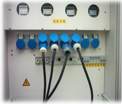
Bildquelle: MPS Elektrotechnik GmbH
