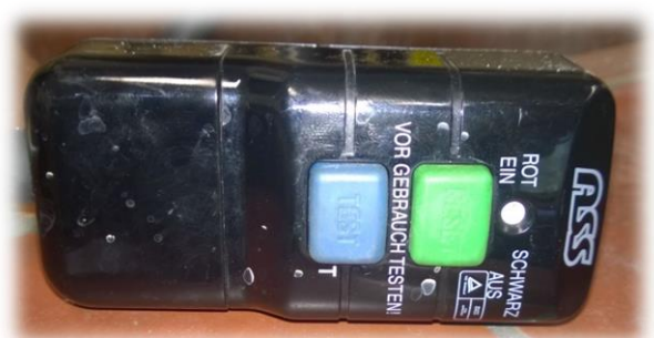
Bildquelle: MPS Elektrotechnik GmbH
