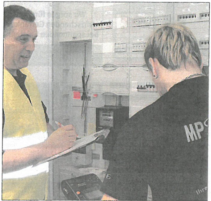
ELEKTRISCHE PRÜFUNG DURCH DIE MPS ELEKTROTECHNIK GMBH.
