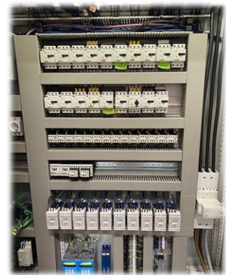
Bildquelle: MPS Elektrotechnik GmbH
