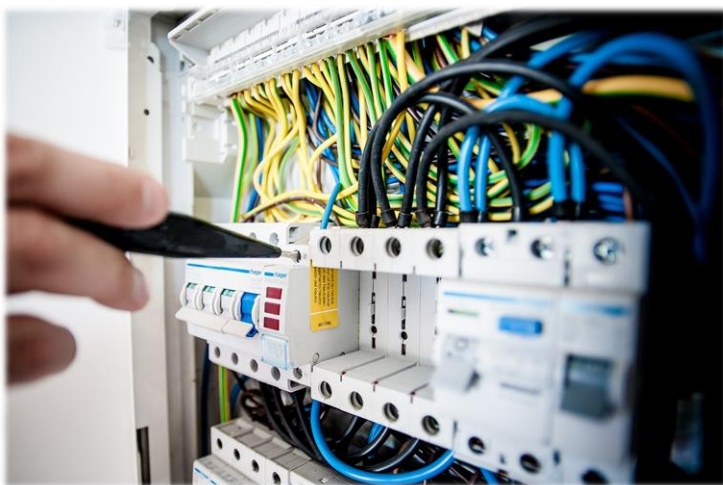
Bildquelle: MPS Elektrotechnik GmbH
