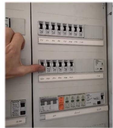
Bildquelle: MPS Elektrotechnik GmbH
