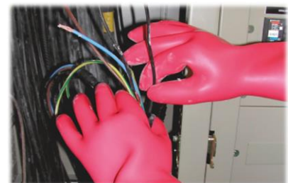
Bildquelle: MPS Elektrotechnik GmbH
