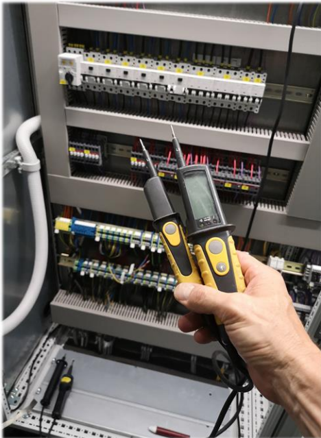
Bildquelle: MPS Elektrotechnik GmbH
