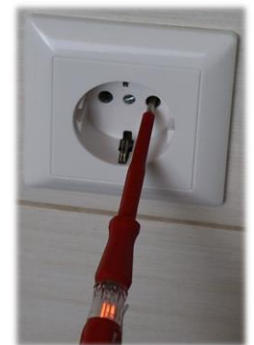
Bildquelle: MPS Elektrotechnik GmbH
