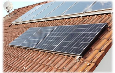
Bildquelle: MPS Elektrotechnik GmbH
