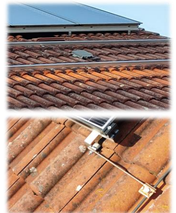
Bildquelle: MPS Elektrotechnik GmbH
